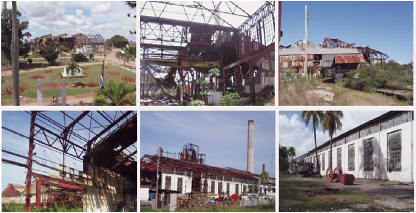
FIGURA 1. Aspecto del deterioro de instalaciones industriales desactivadas de los centrales Amistad, Hershey y Toledo (Fotografía: Adrián González González, Indira Costa Fallarero y Tania Gutiérrez Rodríguez, 2008).
