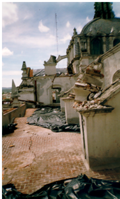
FIGURA 4. Daños en el muro goterón y en botarel (Fotografía: Acrosa, 1999; cortesía: Empresa constructora Acrosa).
