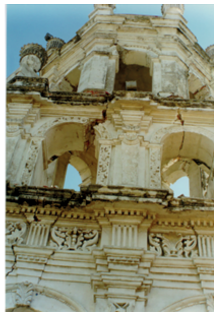
FIGURA 5. Grietas en la torre norte del templo de la Compañía de Jesús (Fotografía: Acrosa, 1999; cortesía: Empresa constructora Acrosa).
