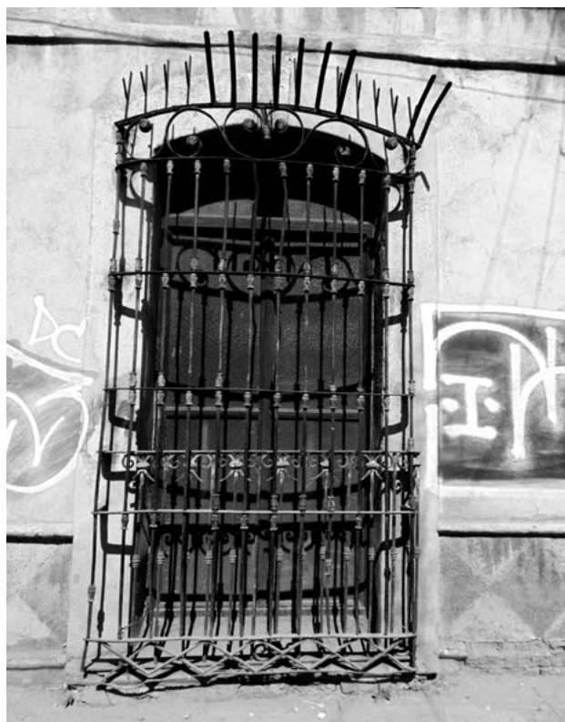
La falta de mantenimiento ocasiona la pérdida de los valores históricos y artísticos Fotografía © Mariana López
