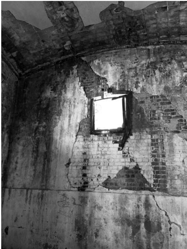
La falta de mantenimiento por años incrementa los deterioros Fotografía © Mariana López
