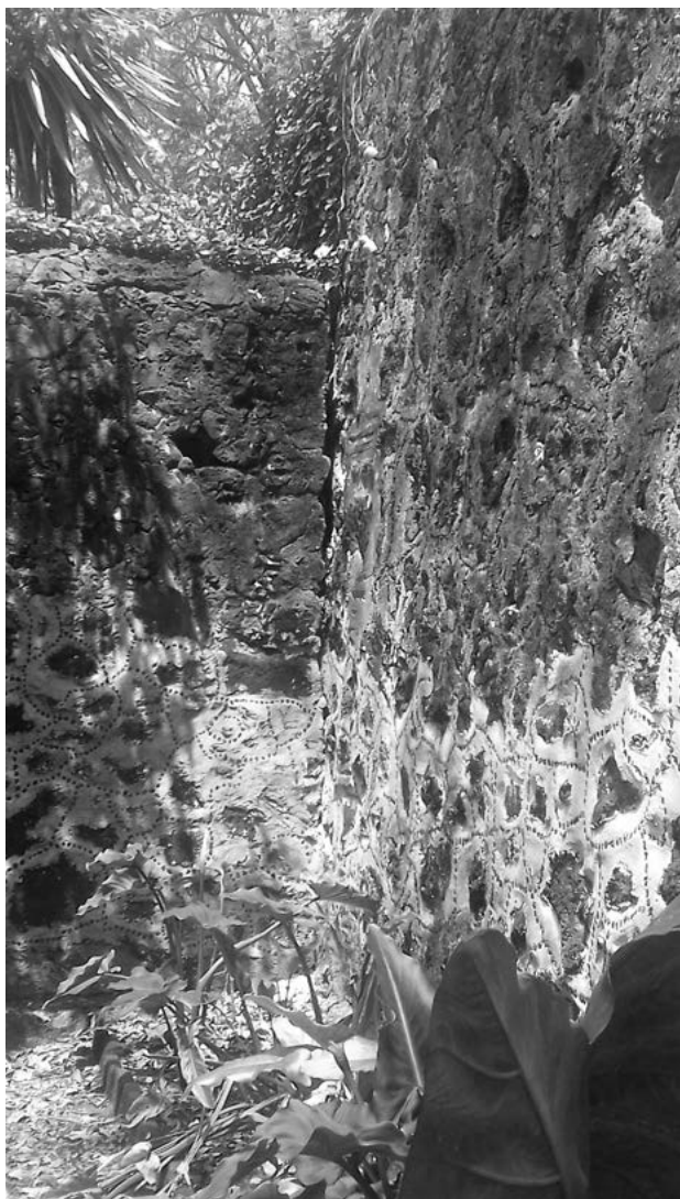
Barda desplomada Fotografía © Juan Manuel Dueñas Serrano
