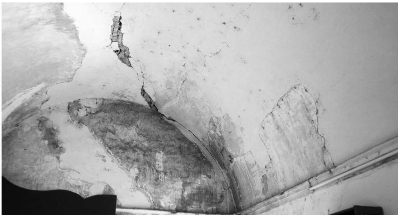
Interior de la bóveda, donde se observan los daños acumulados durante años Fotografía © Mariana López
