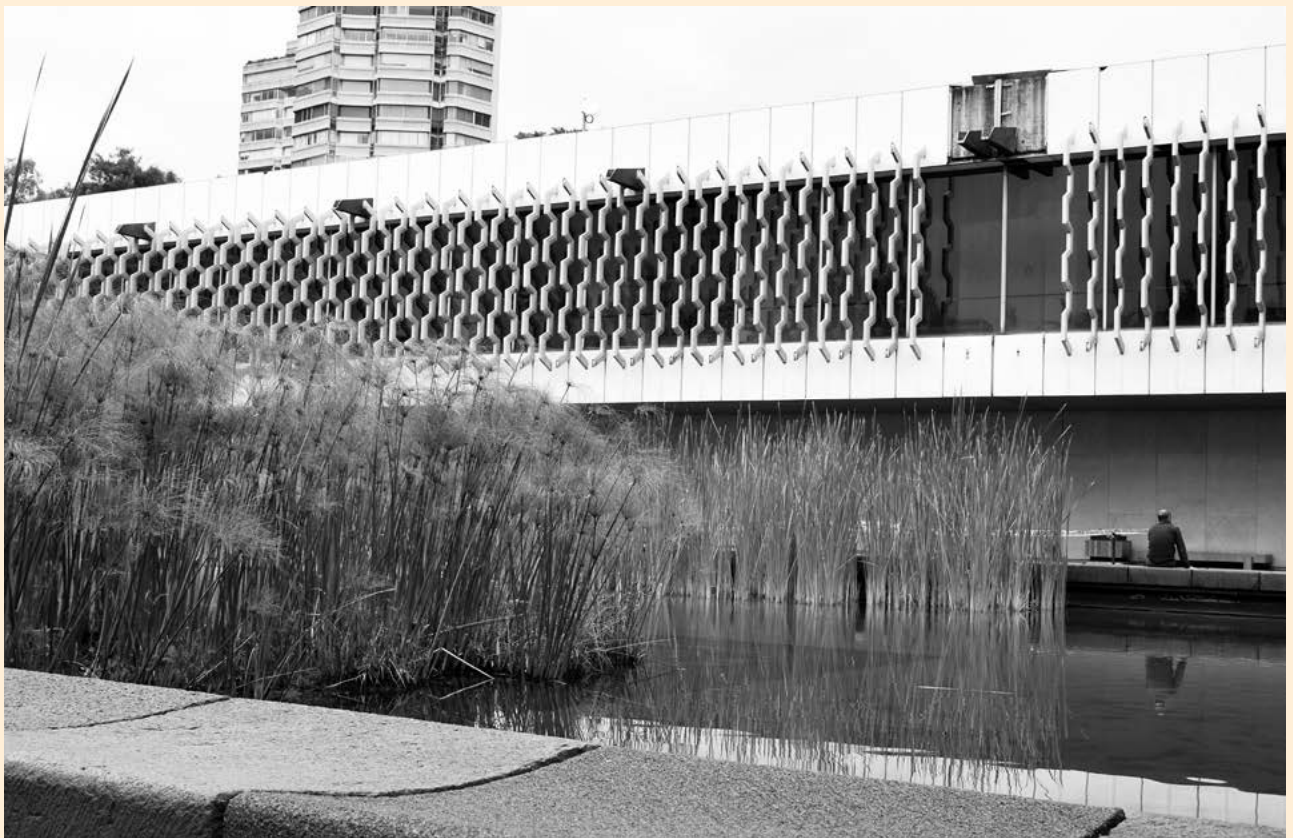
Fachada interior del Museo Nacional de Antropología, donde se aprecia la pérdida de dos fragmentos del acabado de mármol, causada por el sismo del 19 de septiembre de 2017 Fotografía © Norma Edith Alonso Hernández
