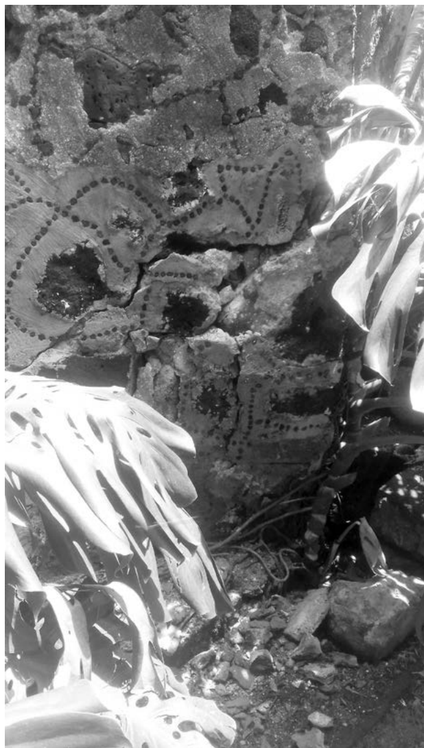
Barda con presencia de grietas Fotografía © Juan Manuel Dueñas Serrano
