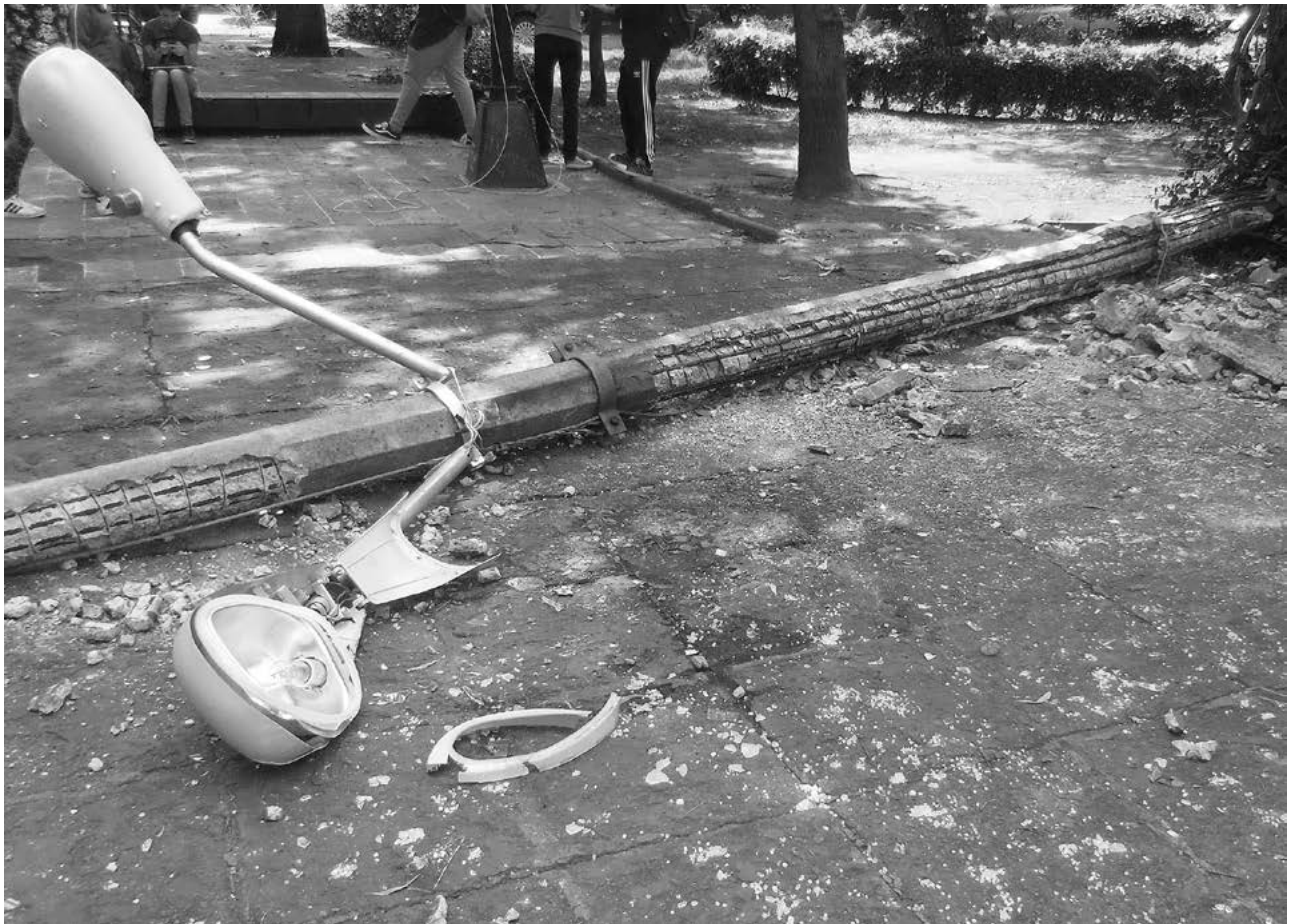
Poste y luminarias frente a la entrada al Museo Nacional de las Intervenciones Fotografía © Juan Manuel Dueñas Serrano
