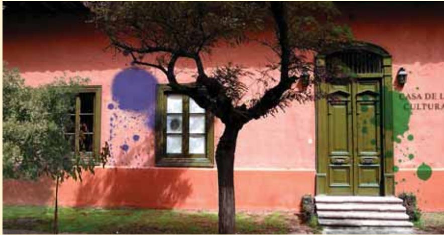
Afectaciones en la fachada de la casa de cultura
