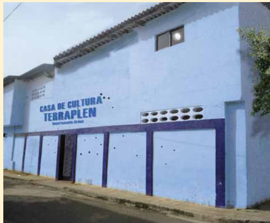
Casa de cultura de Terraplén. Afectación de la fachada en el año 2011.
