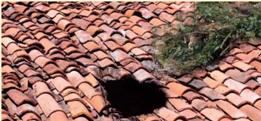
Daños presentados en la cubierta de la casa de cultura por causa del vendaval del año 2010.
