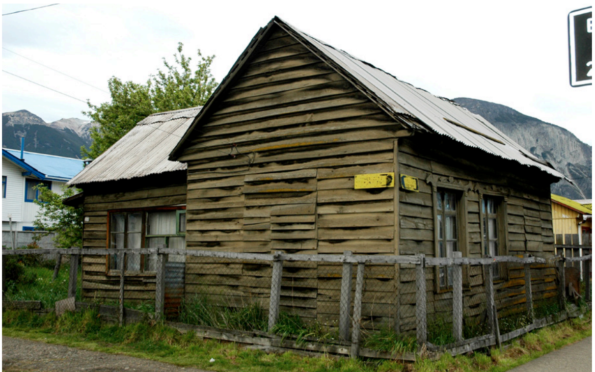
Figura 7. Construcción habitacional en la localidad de Coyhaique, donde la tejuela artesanal del techo ha sido remplazada por planchas de zinc debido a su avanzado deterioro (Fotografía: Castillo, C. 2011). Dwelling house in the village of Coyhaique, where the handmade shingles of the roof were replaced by zinc plates due to advanced deterioration. (Photograph: Castillo, C. 2011).
