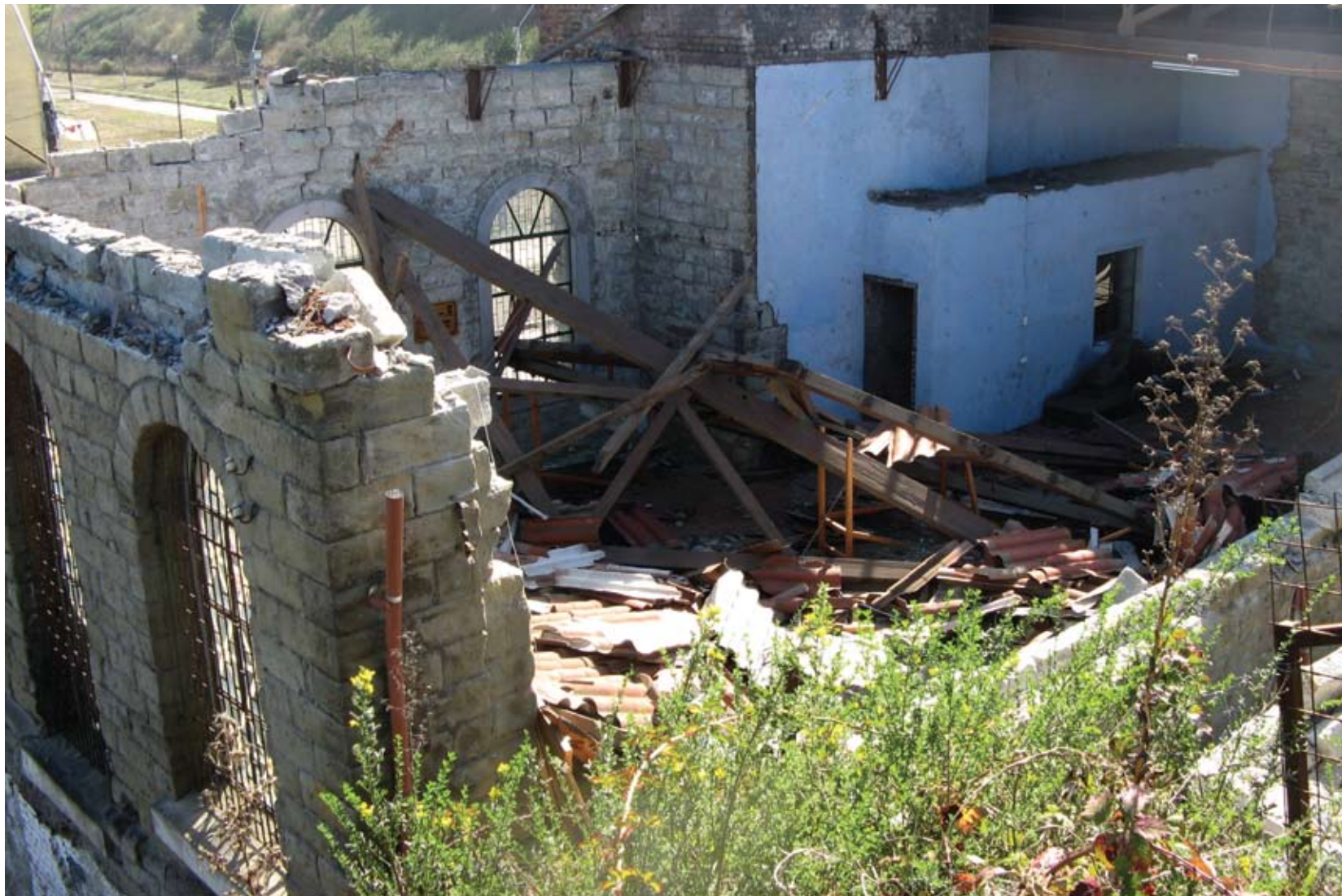
Detalle de los daños provocados en el edificio del Museo Minero Puchoco-Schwager.
