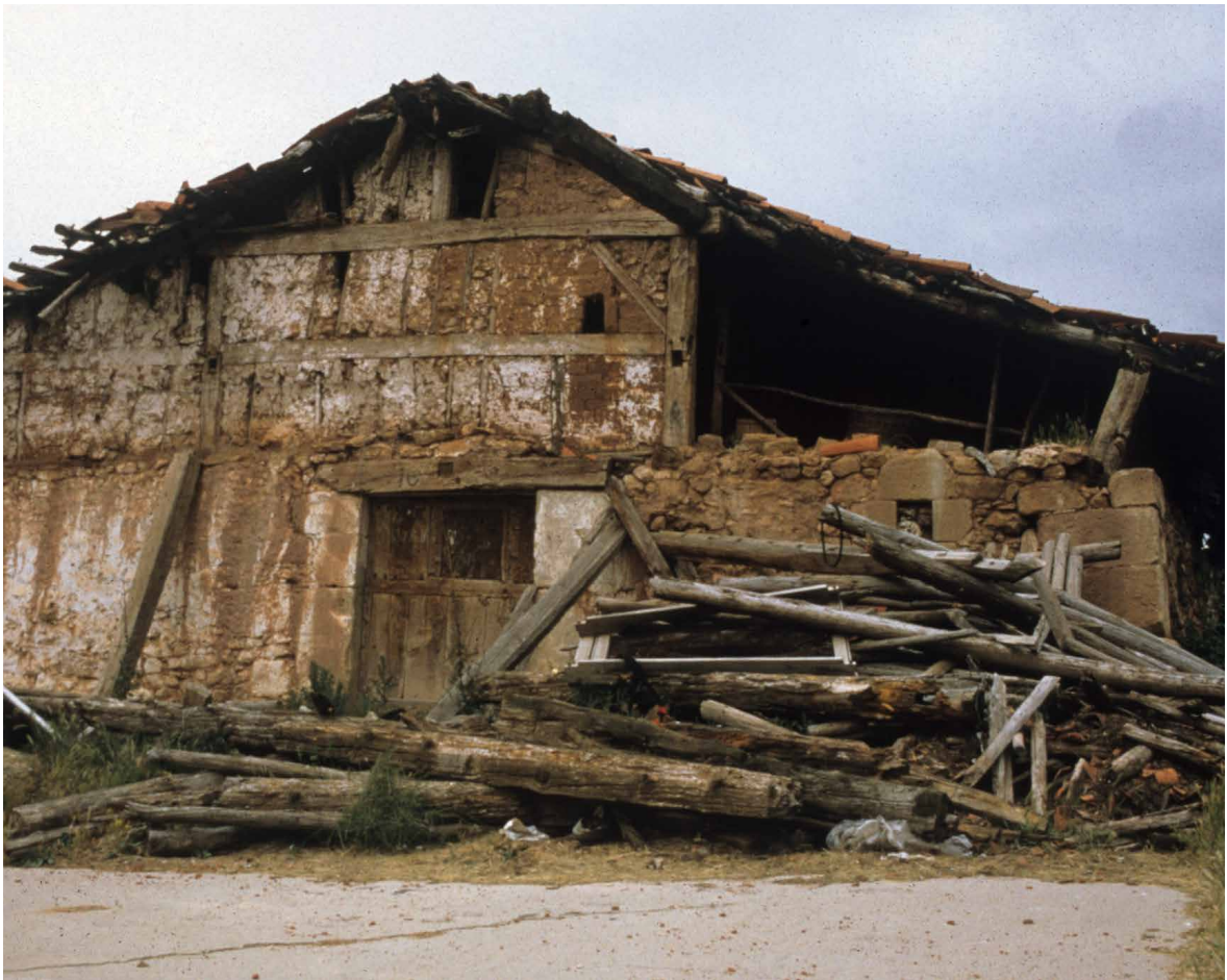
Esta casa, es un ejemplo de ruina por abandono. Es muy interesante tipológicamente por su fachada en hastial con pórtico y su puerta carretera central. La fotografía está tomada a principios de los años noventa. En la actualidad ha desaparecido por completo. Carretera de Pinilla de los Barruecos, en la provincia de Burgos. Fotografía: Félix Benito.
