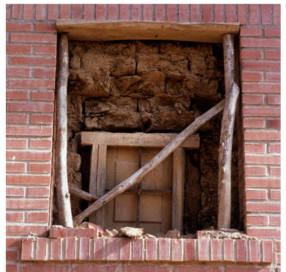
Ventana ocultada de madera y rejería, en el muro de barro, por esta otra industrial, en el muro de ladrillo exterior. Sin comentarios. Fotografía: Félix Benito.
