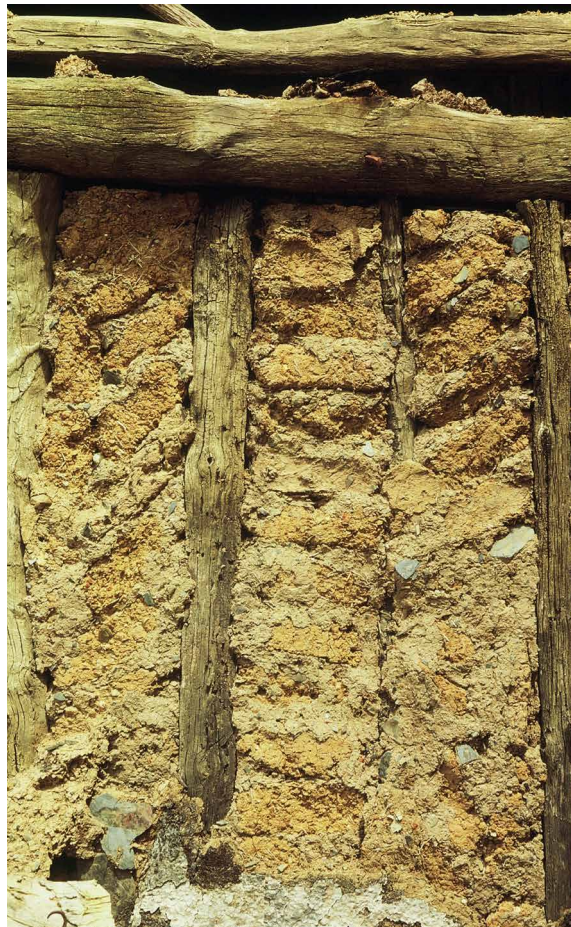
Detalle de entramado de madera con plentería de adobe en Roblelacasa. Fotografía: Luis Maldonado.
