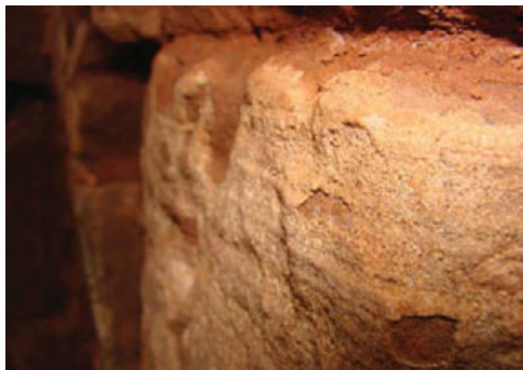
Figura 6. (a) Deterioro mecánico superficial por crecimiento de líquen crustoso mal llamado “hongo blanco” sobre asperón rojo.
