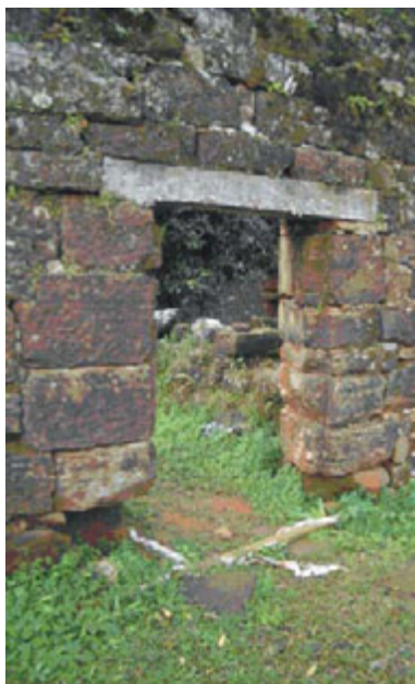
Fig. 10 - Dintel de la restauración realizada por el Arqto. Carlos Onetto entre 1940 y 1948. San Ignacio Miní, Argentina.
