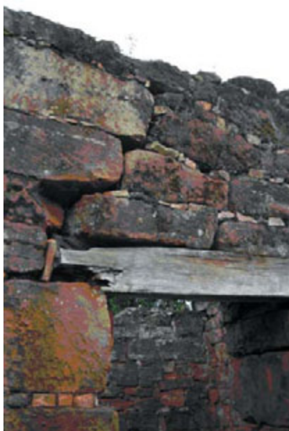
Fig. 11 - Dintel a punto de colapsar por el deterioro de la madera. San Ignacio Miní.
