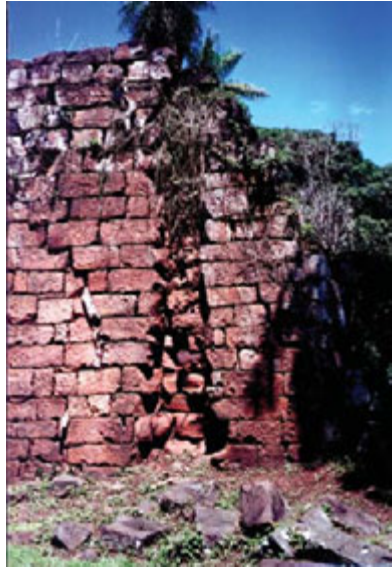
Fig. 9 (izq). Fracturas por incendio de columnas de madera en Santa Ana, Argentina.
