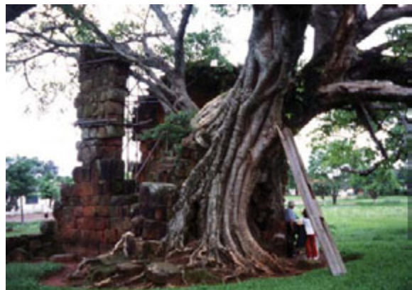
Figura 6. (b) Deterioro mecánico de una estructura por crecimiento de un árbol.
