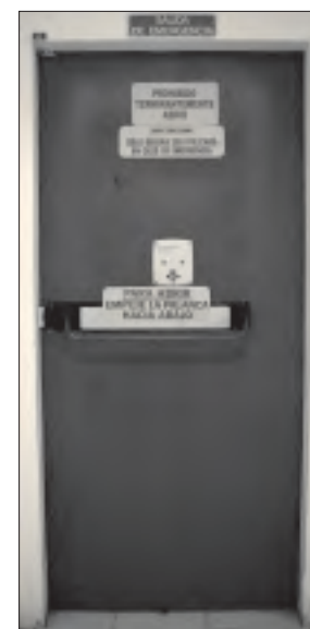
Salida de emergencia
