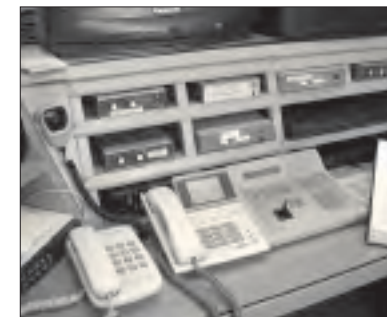
Central de seguridad
