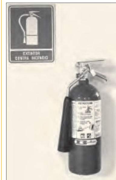
Alarma y extintor de incendios
