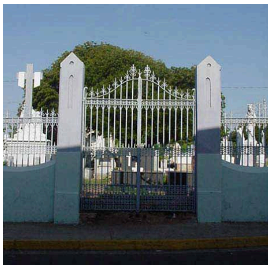
Imagen 49. Cerca de cementerio El Cuadrado. Portón lateral, fachada Este. Archivo: Expediente Cementerio el Cuadrado. Valoración arquitectónica. FAD. 2004.
