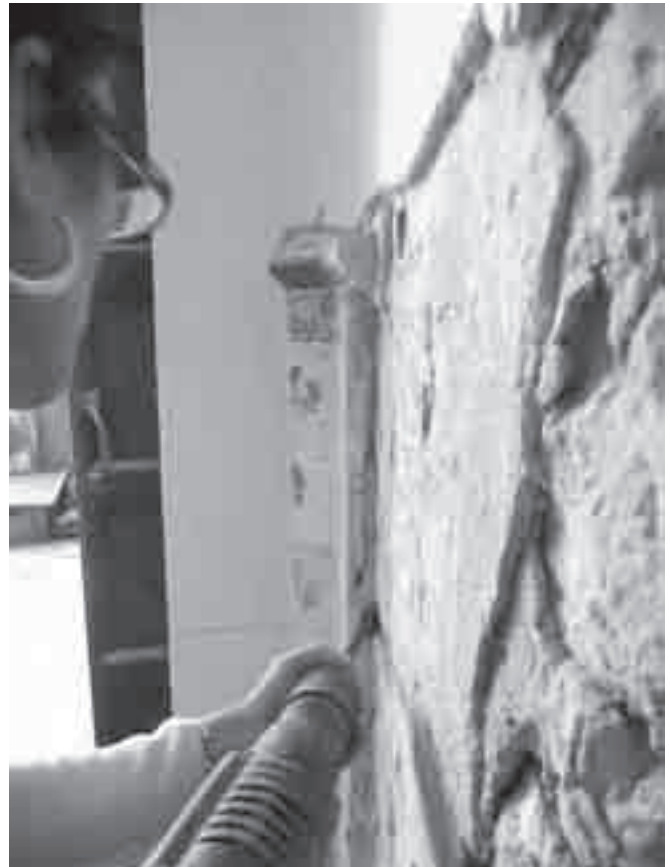
FIGURA 1. Ejemplo de desprendimiento por hileras, actuando entre los repellados y el mortero de unión (Fotografía Montse Agüero 2010, cortesía: ABAC).
