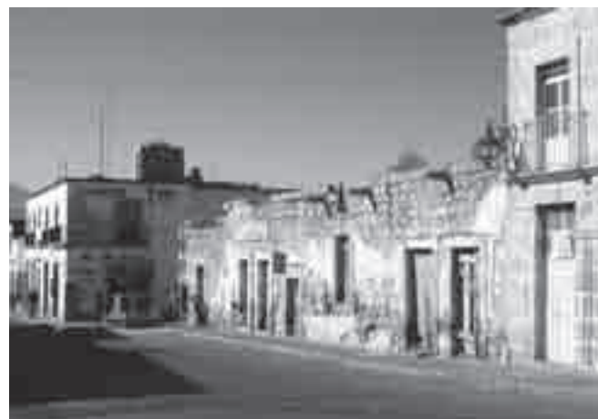
FIGURA 5. Patrimonio edificado en mal estado de conservación. Calle Vicente Santa María. (Fotografía Eugenio Mercado López, 2011).
