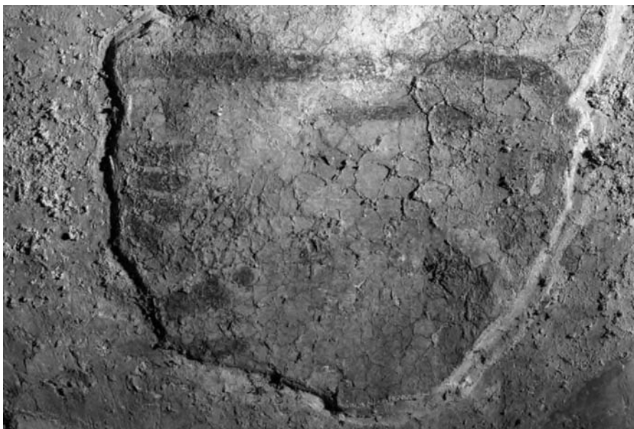
FIGURA. 3. Detalle de la pintura mural de Símbolos Solares donde se aprecian velos salinos y deposiciones calcáreas entre las líneas de ruptura de las craqueladuras.
