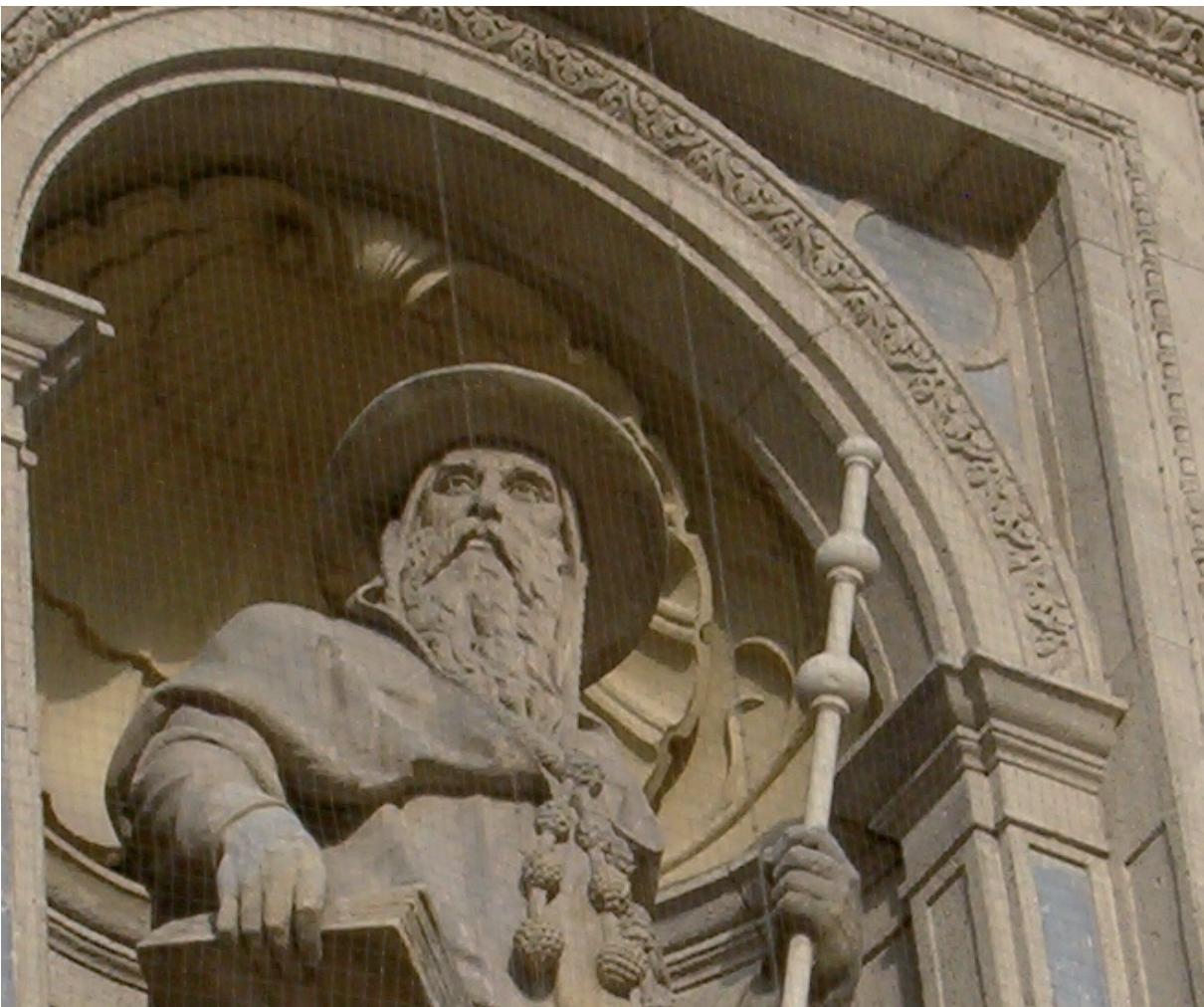
Figura 8. Columba livia . Daños en patrimonio asociados a nidificaciones de palomas. Red de protección. San Istzvan, Budapest, Hungría. Fotografía: UTCV-Salud Ambiental.
