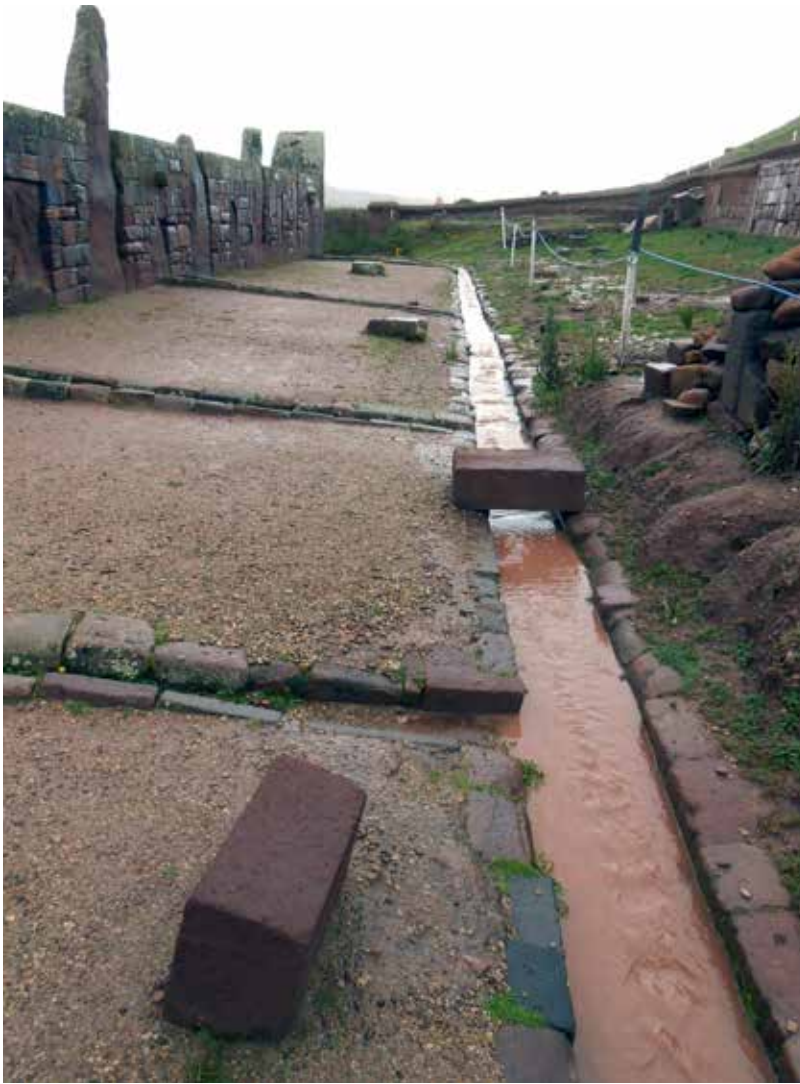
Rehabilitación de salidas de agua como medida de protección. Conducción de aguas pluviales precolombina en Tiwanaku, Bolivia. 2014.
