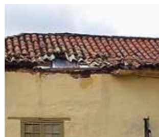
Detalle de la parte exterior de un museo en Bogotá, afectado por el lanzamiento de un rocket, atentado que ocasionó diversos deterioros tanto en la estructura del edificio como en la colección de bienes muebles que albergaba.
