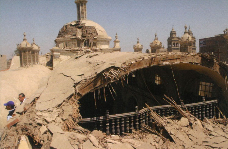
En la Catedral de Ica se han registrado grietas en las arquerías de las naves y en los muros de adobe, quedando expuesta la madera y la quincha de la edificación.
