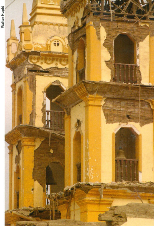
Iglesia de Santiago Almagro en Chincha Baja, construida en el siglo XVIII. Su estructura resistió pero las torres se vieron afectadas.
