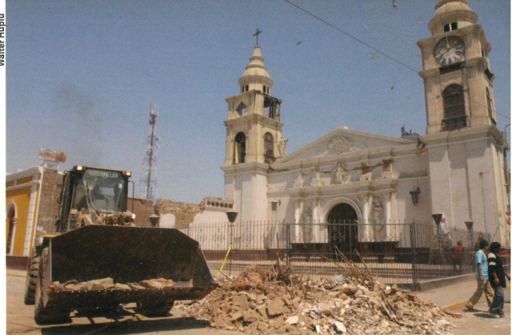
La Catedral de Ica, edificada en 1759 como iglesia de La Compañía, fue convertida en Catedral por Bolívar tras la independencia. La fachada presenta grietas en varios sectores.
