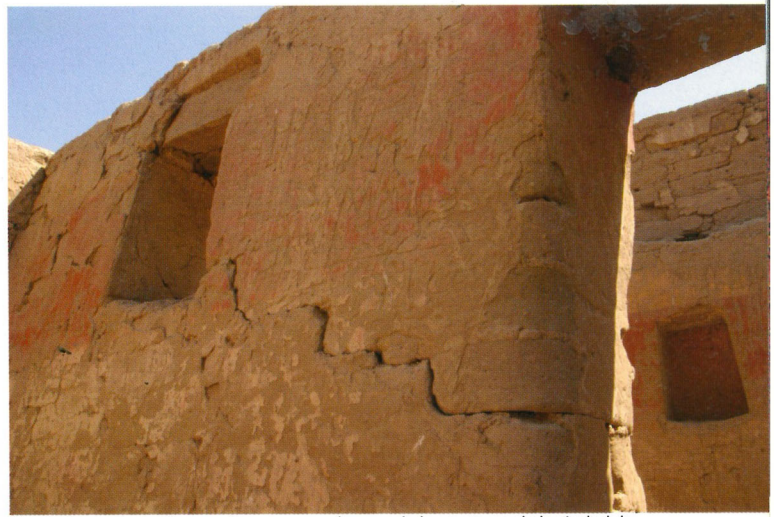
Fisuras impresionantes pueden verse en algunos de los sectores de la ciudadela inca de Tambo Colorado.
