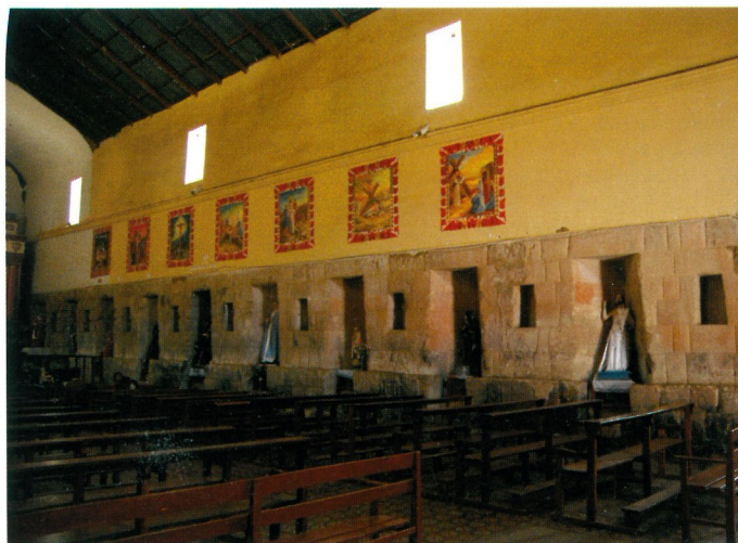
Interiores de la iglesia de Huaytará, la única en el Perú edificada sobre una construcción inca. Diversas fisuras se han apoderado de su estructura.
