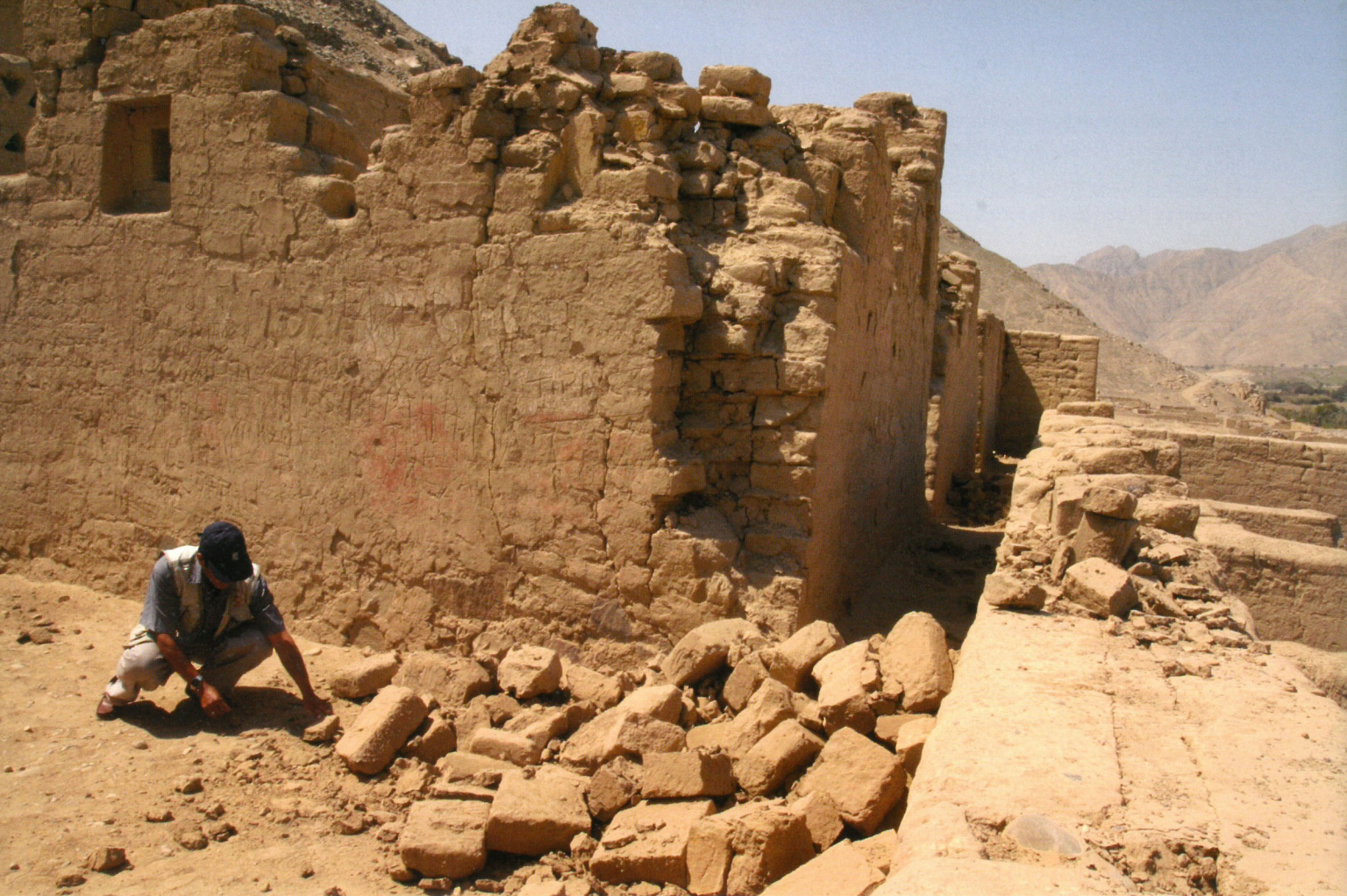
El centro administrativo inca de Tambo Colorado, ubicado en el distrito de Humay, Pisco, muestra agrietamientos y colapsos parciales en las paredes de los recintos más importantes.
