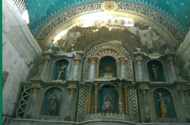
Delante del muro testero se ubica el retablo principal de estilo neoclásico. Tiene los bordes de yeso despostillados.
