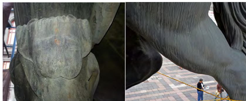
Figura 5. Zonas no intervenidas y prácticamente no dañadas donde se muestra la capa de corrosión / pátina de la escultura, hollín y los típicos escurrimientos de lluvia. Cortesía de Gabriela Peñuelas y Ricardo Castro, INAH.
