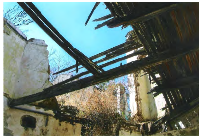
Figura 3. El entrepiso y la cubierta que corresponden a la torre, al igual que en todo el edificio, estaban colapsadas. Cedieron al paso del tiempo y las estructuras de cubiertas se perdieron, ocasionando los demás deterioros: deslave de cabezales de muros, pérdida de aplanados, crecimiento de flora, invasión de fauna nociva. El abandono es evidente.
