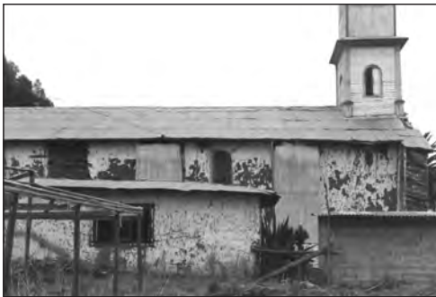
Falta de mantención (*).
