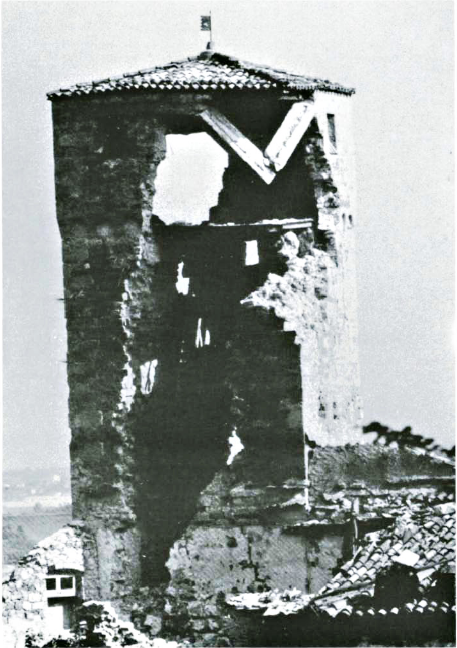
Fig. 12 Daños en un castillo. Terremoto de 1976, Artegna, Italia.
