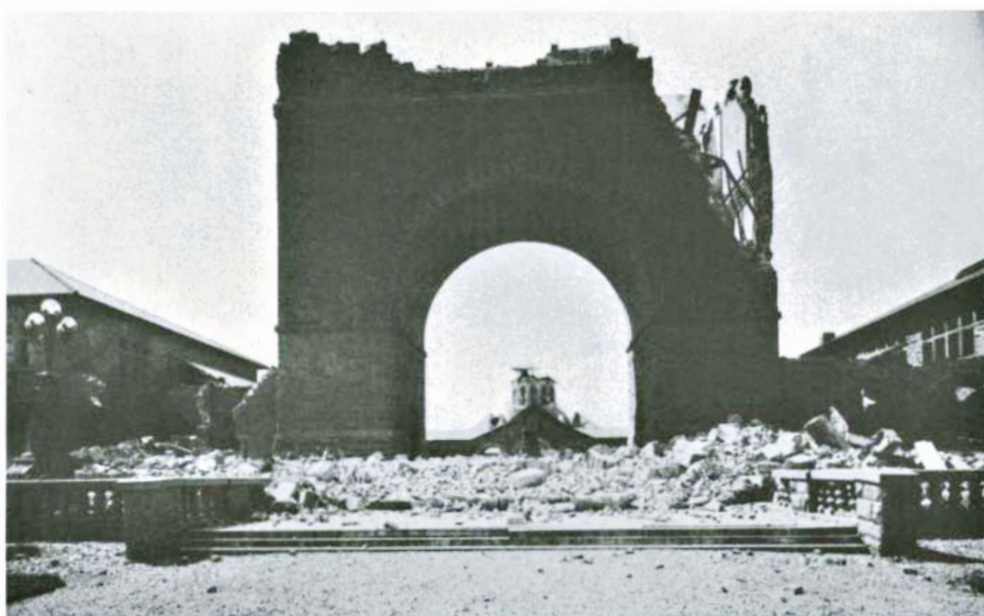
Fig.1 Arriba: El Memorial Arch de Stanford University, después del terremoto de 1906. Abajo: Vista de la otra cara del arco. La parte superior del arco se eliminó posteriormente dejando solo dos torres de guardia.
