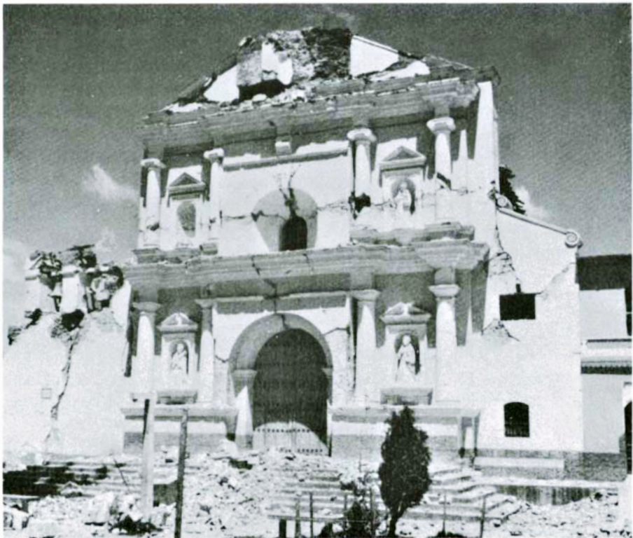
Fig. 3 Catedral que muestra fisuras sobre los arcos ocasionadas por el terremoto del 4 de febrero de 1976. Tecpán, Guatemala.
