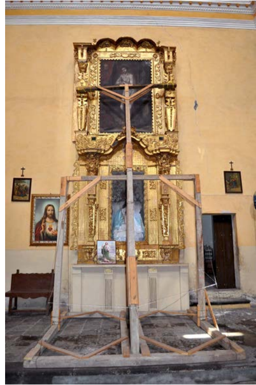
Figura 10. Retablo lateral de la Virgen de la capilla de la Tercera Orden de Atlixco. El apuntalamiento impide los movimientos al frente provocando desajustes. Imagen: Pablo Vidal Tapia, © CNCPC-INAH, 2017.
