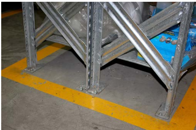
Figura 4. Los estantes se fijarán en el piso, paredes y techo para evitar su caída durante los movimientos sísmicos. Imagen: Bertha Peña Tenorio, ©CNCPC-INAH, 2018.
