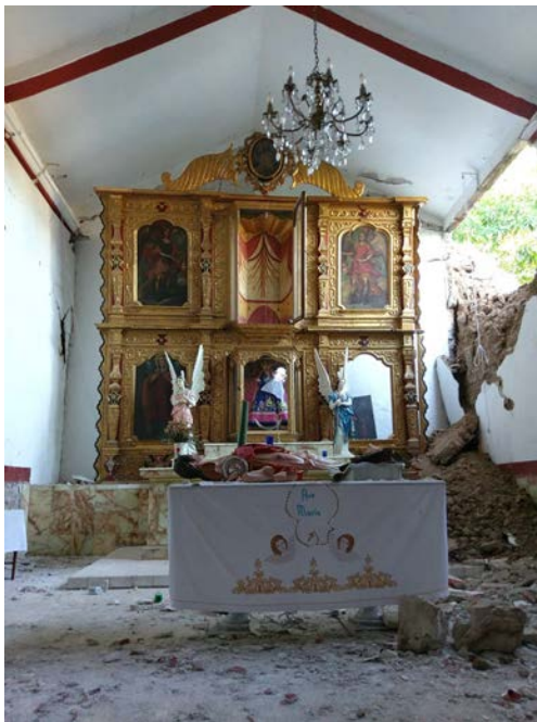
Figura 3. Retablo principal con desplomes y muro lateral deslavado. Templo de San Sebastián Tehuantepec. Imagen: Christian Chávez González, ©CNCPC-INAH, 2017.
