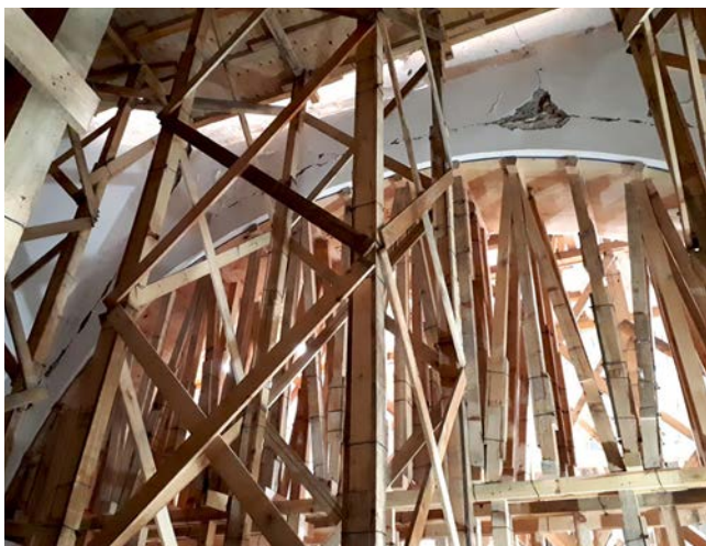
Figura 6. Apuntalamiento de las cubiertas en el templo de Santa María Petapa. Imagen: Mauricio Olayo Pineda, ©Aseguradora York, 2018.
