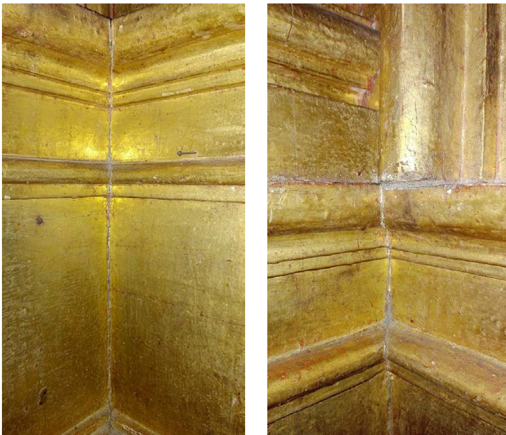
Figuras 12 y 13. Grietas en dorados del retablo de San Francisco. San Cristóbal de Las Casas, Chiapas. Imagen: ©Arturo Sebastián Casasola Busteros, CNCPC-INAH, 2017.
