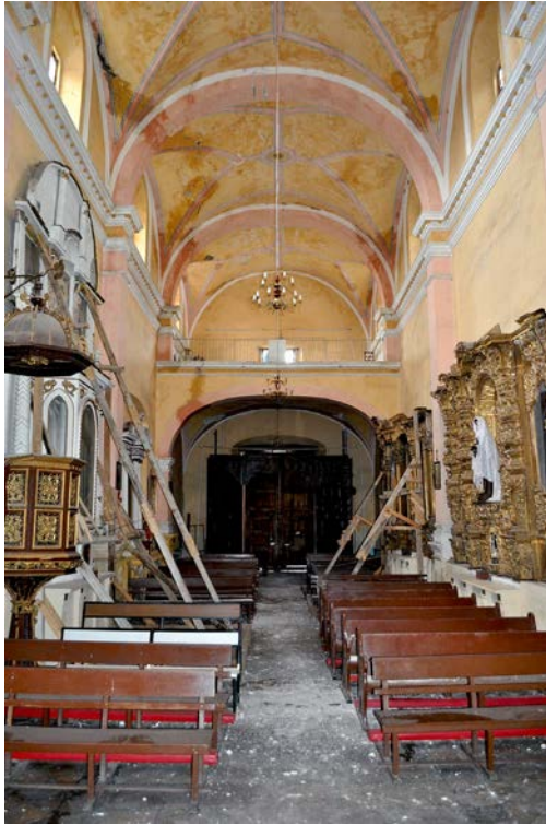
Figura 9. Vista general de la nave de la capilla de la Tercera Orden de Atlixco donde se observan los retablos apuntalados desde el 2012. Imagen: Pablo Vidal Tapia, © CNCPC-INAH, 2017.
