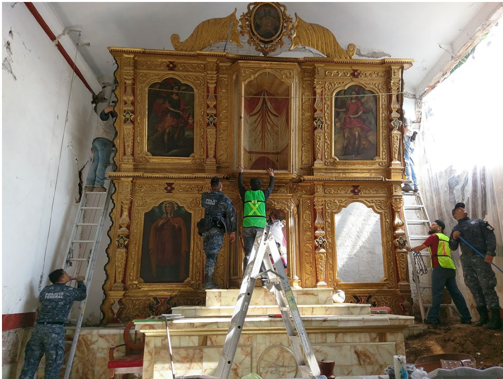
Figura 4. Zunchado del segundo cuerpo del retablo para la recuperación de la verticalidad. Templo de San Sebastián Tehuantepec. Imagen: Irene Hernández Flores, ©CNCPC-INAH, 2017.
