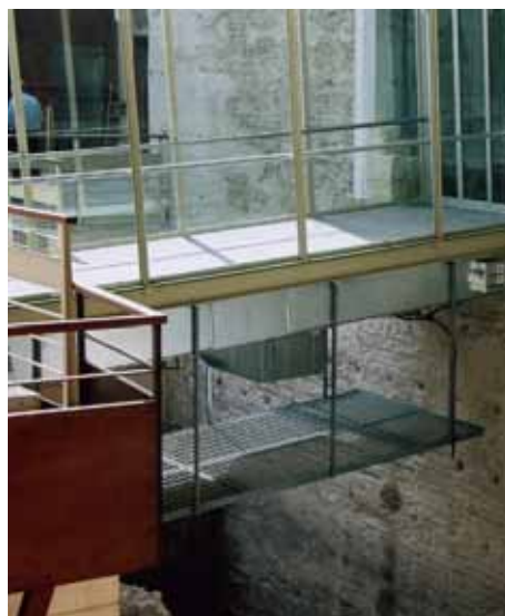
6. Detalle instalación de acondicionamiento de aire bajo la pasarela de acceso (Foto: Magdalena Barril).
