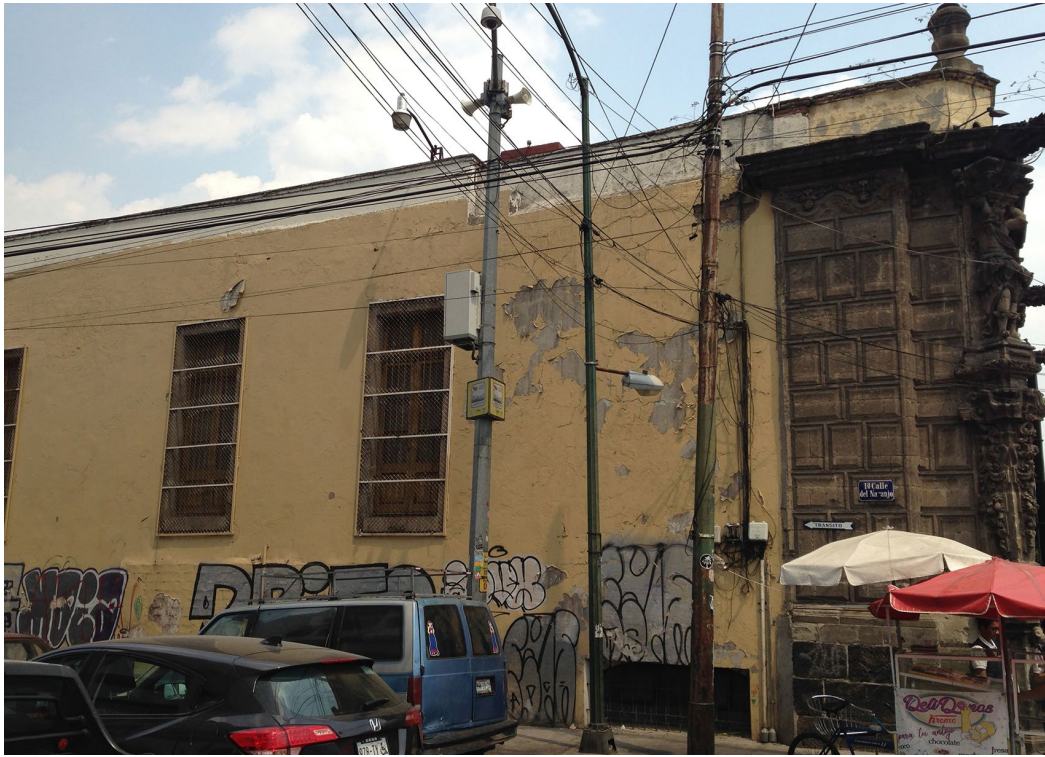
Figura 4. Barda poniente de la Casa de los Mascarones. En una parte de la esquina se aprecian elementos de la fachada principal, pero se corta de tajo y da lugar a una pared desgastada y de mal aspecto. Imagen: ©Misael Armando Martínez Ranero, 2019.
