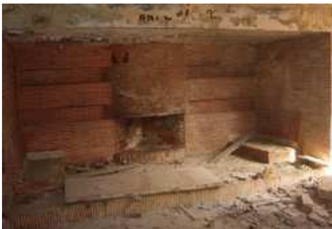
Zona de la chimenea del albergue de carretera en Bailén (2014) | foto autores
