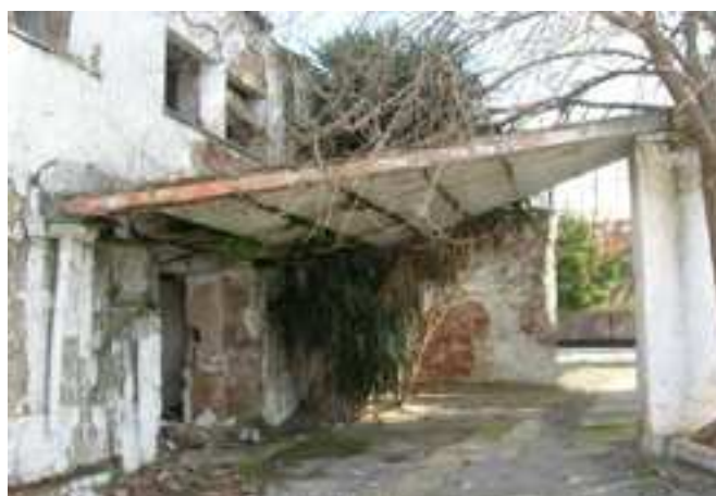
Ruina del albergue de carretera en Bailén (2014) | foto autores
