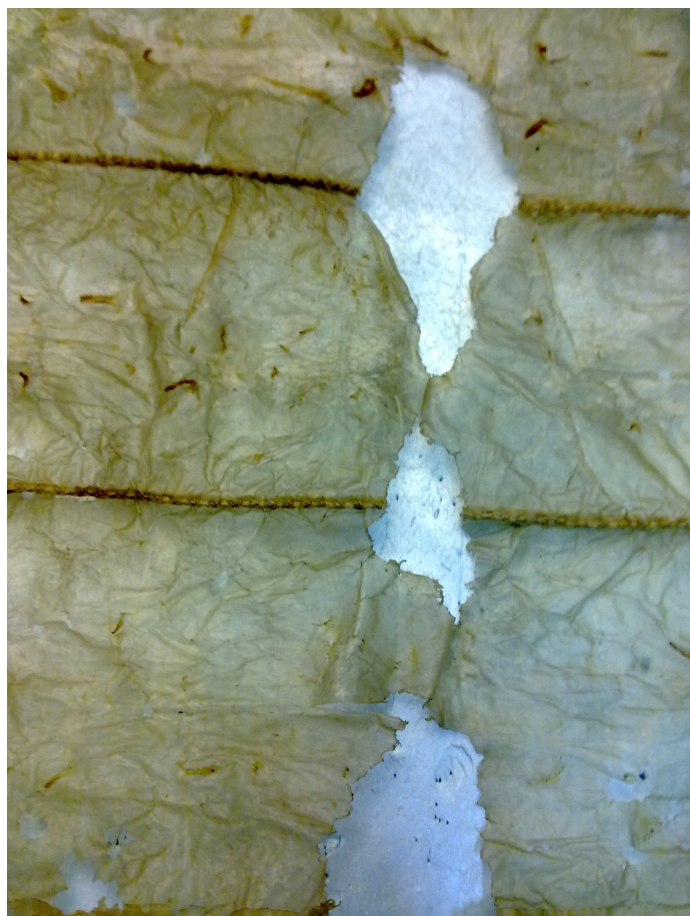
Figura 24. Foto inicial de los rotos del interior.
