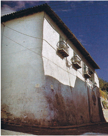
Figura 7: Casa de la Peña, donde se creía erróneamente que vivía Miguel de Santiago
